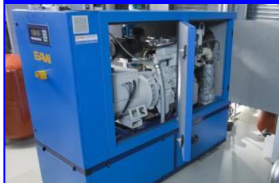
KWK Einheit + Warmwasser-Speicher
